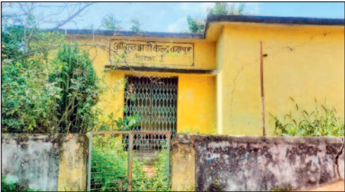
निर्माण के केवल 8 वर्षों में ही जर्जर हो गया भवन।
